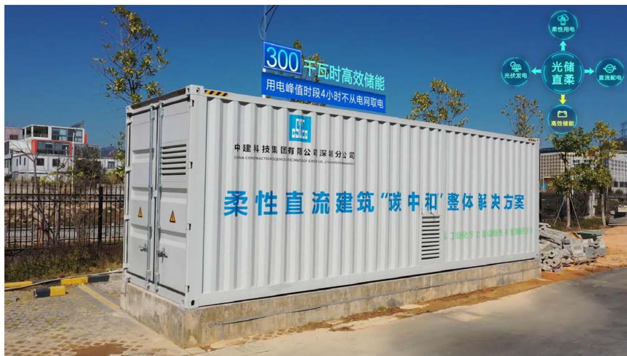
图 2.8 深汕特别合作区中建绿色产业园储能系统
