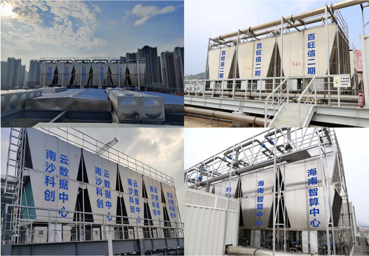
图 11.2 惠州、海南等多项目冷却塔现场
