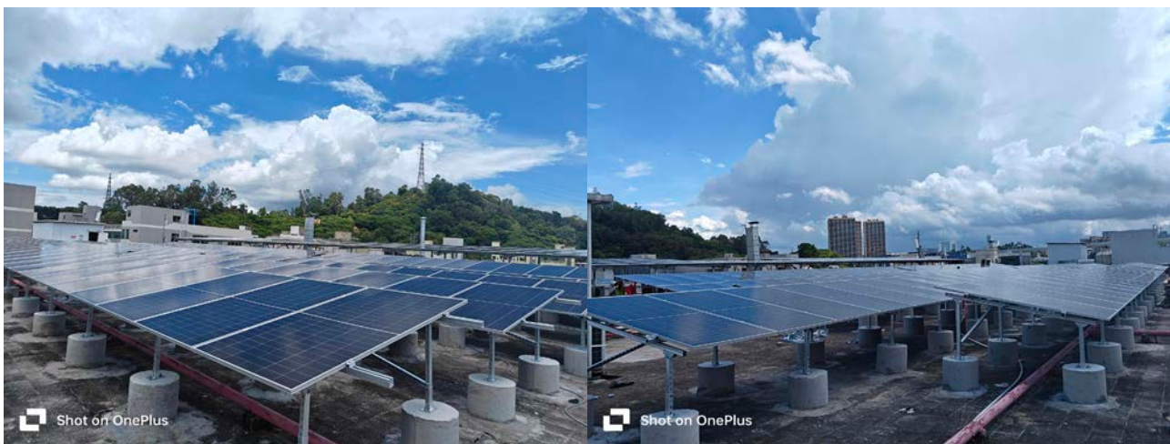
图 3.1 屋顶分布式光伏实景图
